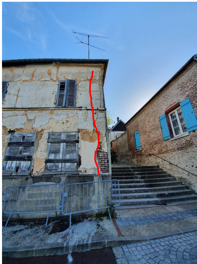
Angle lézardé ; atteinte à la solidité de l'ouvrage ; risque d'effondrement de portion de façade
