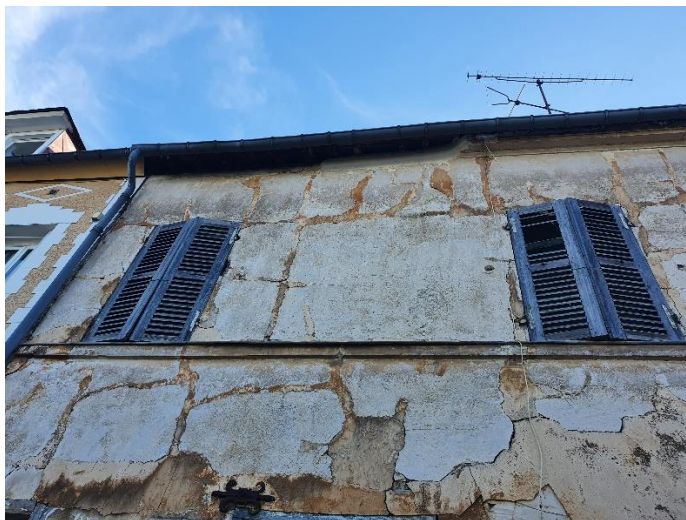
Risque de chute d'enduit
