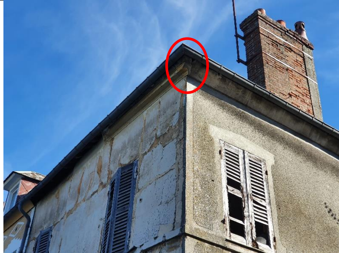
Risque de chute de corniche
