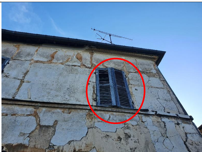
Volets délabrés et mal fixés
