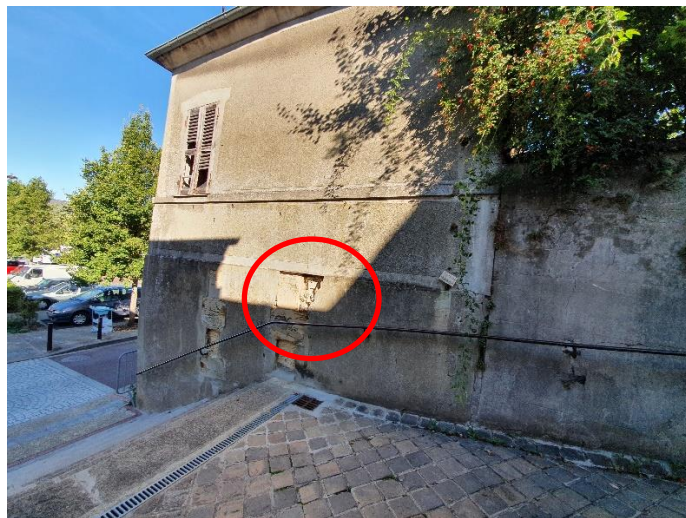
Trous dans la façade
