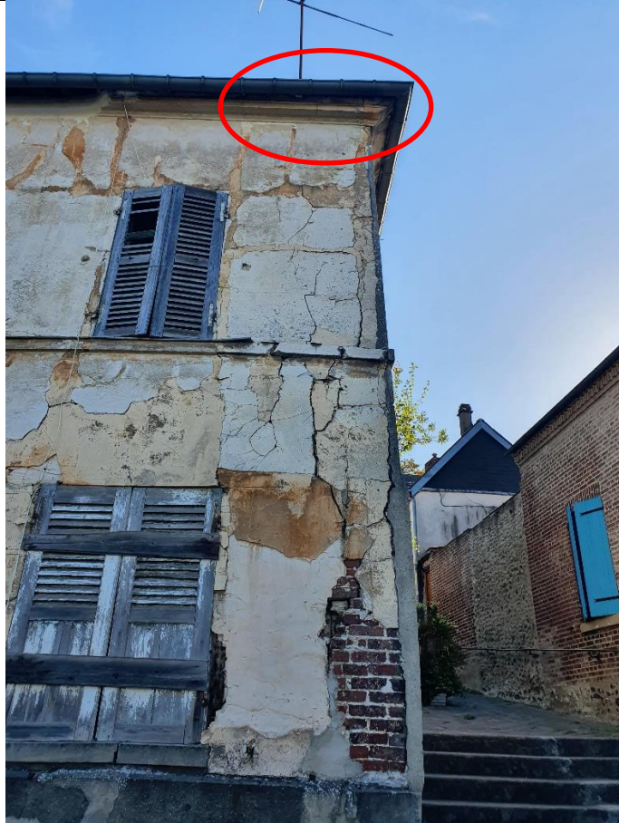
Corniche à sécuriser
