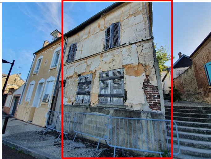
Façade sur Place du Jeu de Paume ; multiples fissures et enduit dégradé
